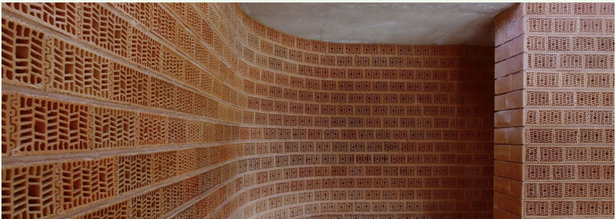
Pabellón multideporte con bloque Termoarcilla en Güevejar (Granada). Arq. Juan Moya Arquitectura
